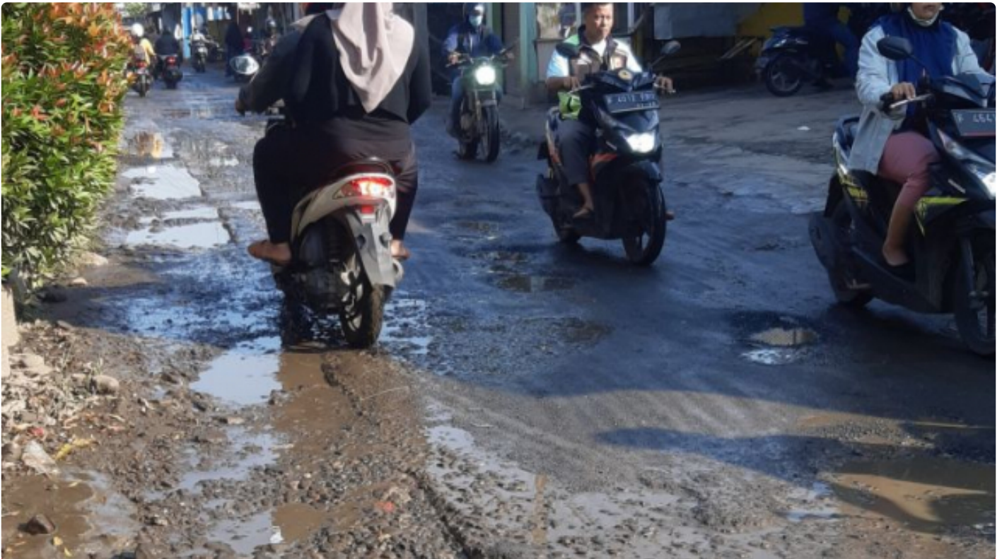
Kondisi Jalan Industri Tarik Kolot ( Dok. Pribadi)
